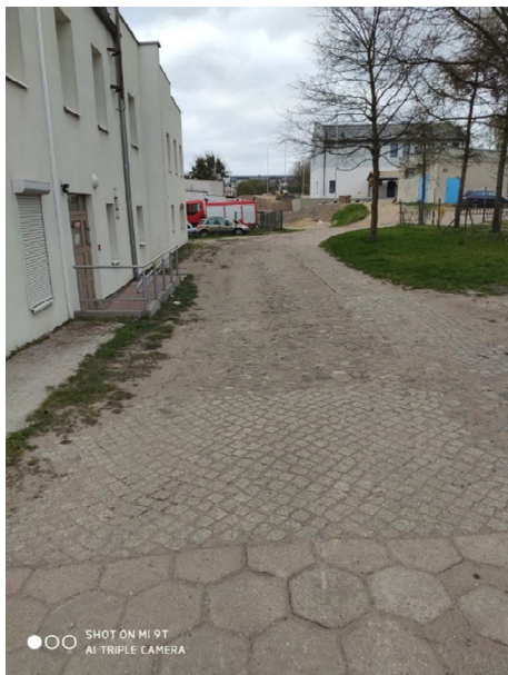
Zdjęcie nr 1: Nawierzchnia z kostki kamiennej, kamienia brukowego posiadająca wiele nierówności
