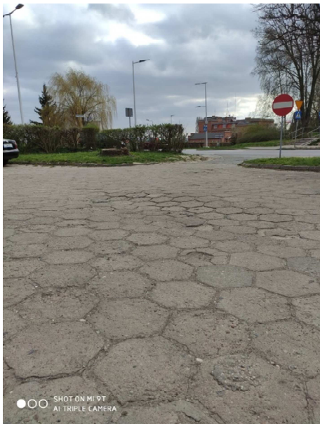
Zdjęcie nr 4: Nawierzchnia z kostki betonowej typu „trylinka” posiada nierówności, na których tworzą się kałuże po opadach
