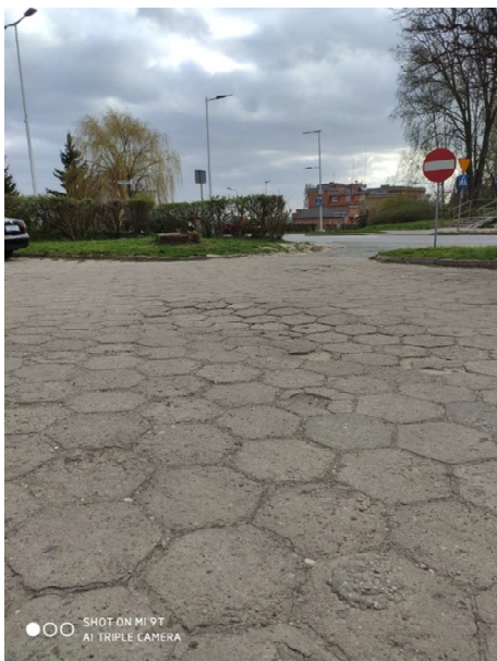
Zdjęcie nr 4: Nawierzchnia z kostki betonowej typu „trylinka” posiada nierówności, na których tworzą się kałuże po opadach
