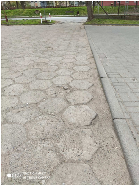
Zdjęcie nr 3: Nawierzchnia z kostki betonowej typu „trylinka” posiada uszkodzenia
